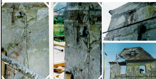
Špatný stav konstrukcí průčelní stěny před sanací
