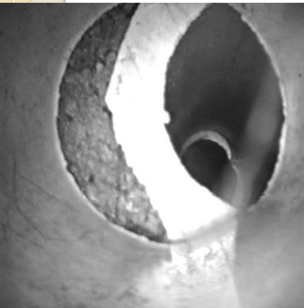
Chyby při výstavbě
