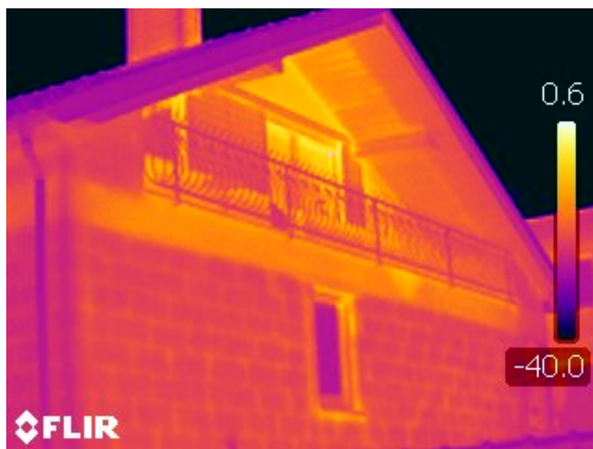
Obrázek 8.9: Termogram kontroly kvality těsnosti oken.
