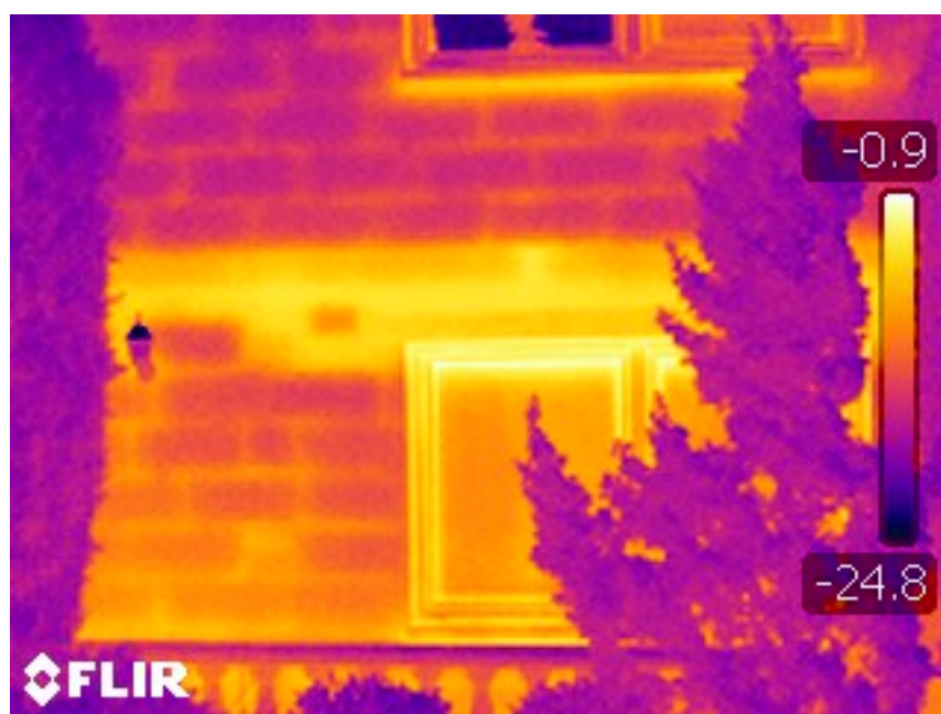
Obrázek 8.8: Termogram pro zjištění tepelných mostů stavby.
