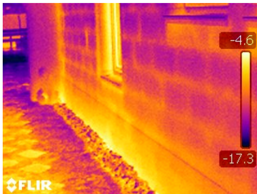
Obrázek 8.7: Termogram pro kontrolu úniku tepla stavby.
