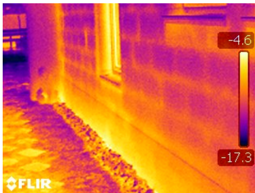
Obrázek 8.9: Termogram pro kontrolu úniku tepla stavby.
