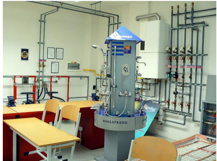
Obrázek č. 5: Ukázka odborné učebny pro výuku oboru instalatér, střední škola polytechnická, Jílová, Brno ( www.jilova.cz/index.php )
