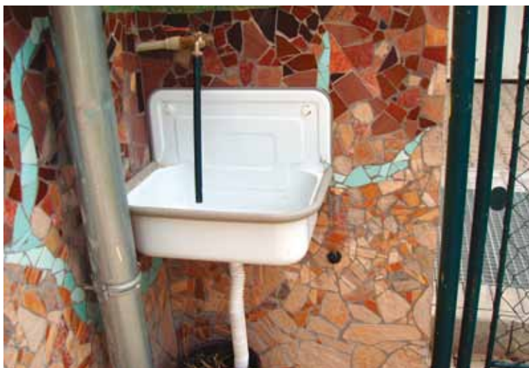
Lehce přístupné umyvadlo na zahradě.
