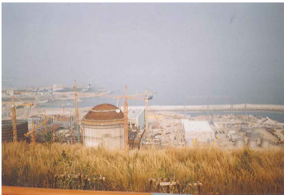
Výstavba 4 nových bloků Shin Kori na pobřeží Japonského moře u jihokorejského Pusanu.
