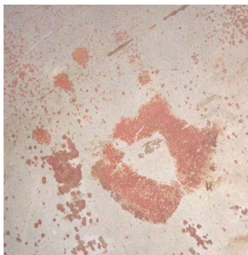
Koroze železa vlivem chloridů z potu
