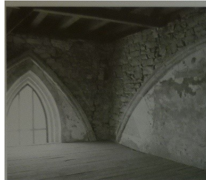
Přístěnná žebra pro uložení bednění západního pole klenby nad lodí bývalého kostela sv. Anny kláštera dominikánek na Starém Městě v Praze z 1. poloviny 14. století. Obdélná klenební pole měla stejnou výšku čelních oblouků, z nichž kratší byly hrotité.
