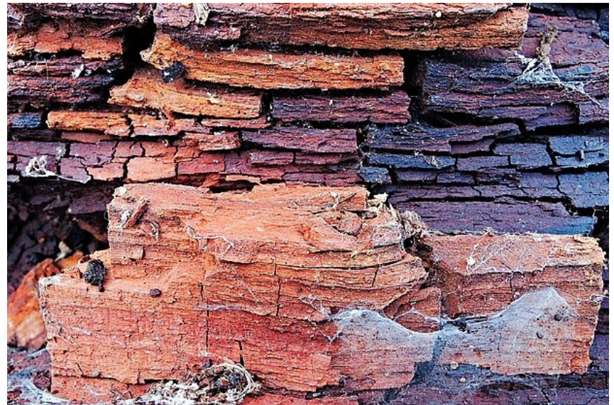
Dřevo poškozené dřevomorkou – kostkovitý tvar
