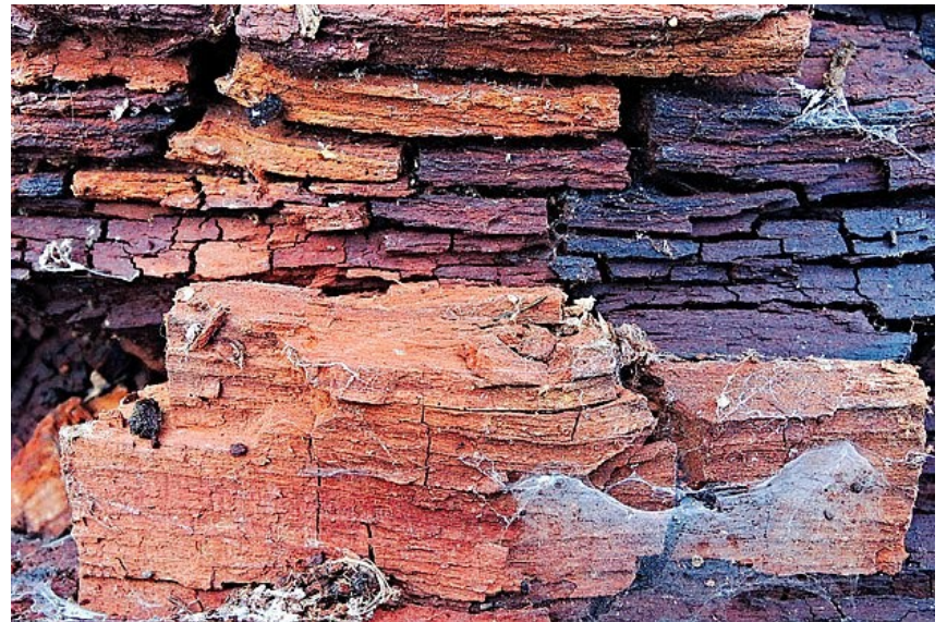
Dřevo poškozené dřevomorkou – kostkovitý tvar
