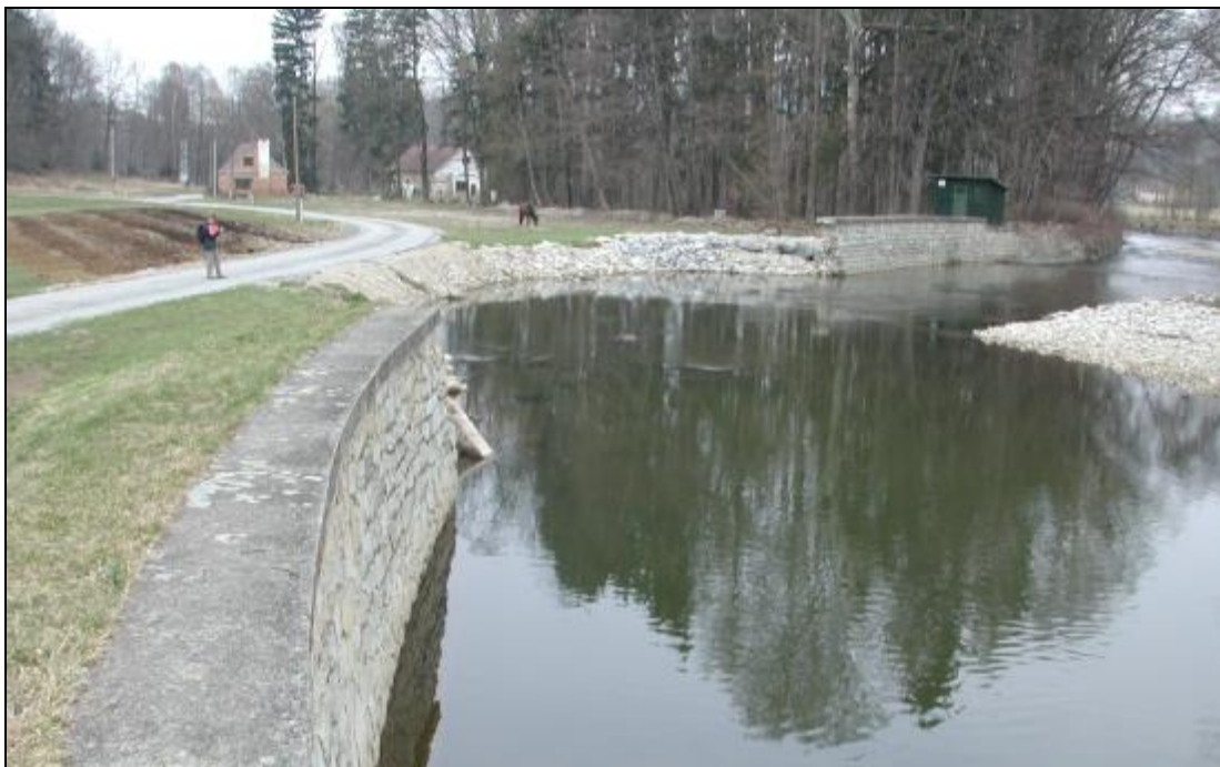
Obr. 11 Protržený protipovodňový val a zpevněný břeh na Volyňce pod Volyní. V průběhu povodně směřovala hlavní proudnice do prostoru směrem na rodinné domy
