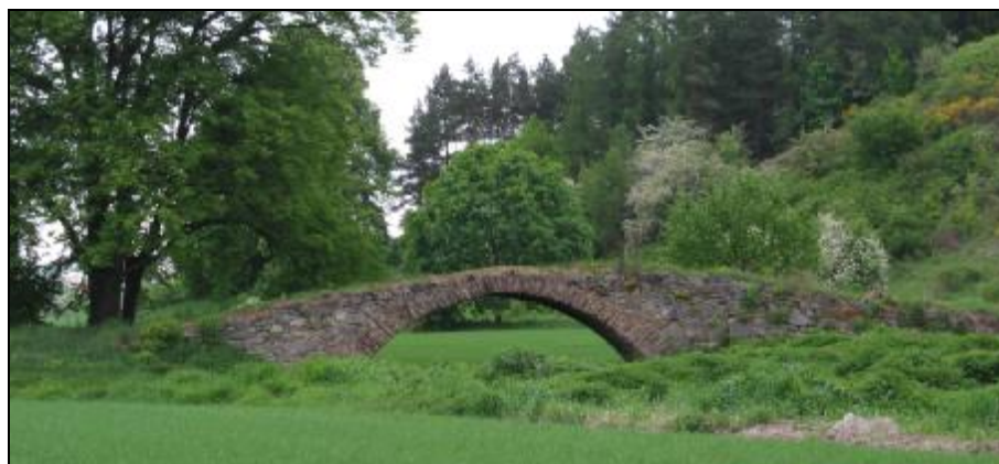
Obr. 7 Žižkův most. Přeložení koryta Březového potoka po regulaci ve 20. letech 20. století zanechalo původní středověký most na suchu, mimo současné koryto toku (Foto: J. Langhammer, 2003)
