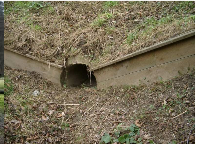
Podchod pro obojživelníky pod silnici - trvalé opatření (Rakousko)
