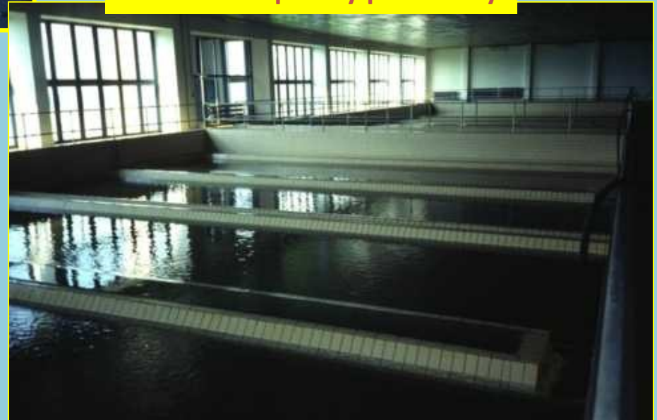
Pitná voda úpravny pitné vody
