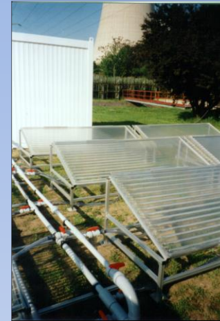
Purification des eaux industrielles
