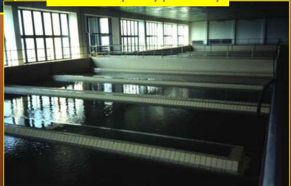
Pitná voda úpravny pitné vody
