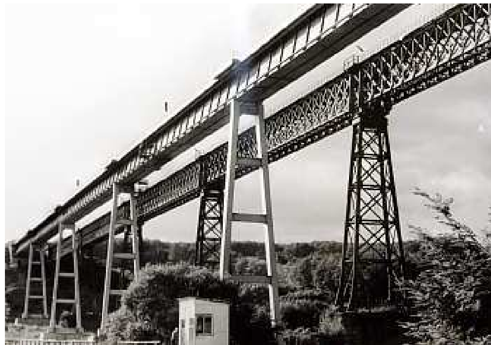
Ivančický viadukt, jeden z prvních celokovových mostů ze svářkového železa a litiny v Rakousko-uherské monarchii, r. 1870 (foto z r. 1978)
