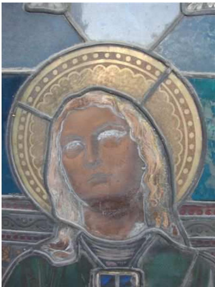
Projevy koroze na vitráži kostela sv. Cyrila a Metoděje v Praze (foto: P.Coufal – Umělecká huť sklenářská)
