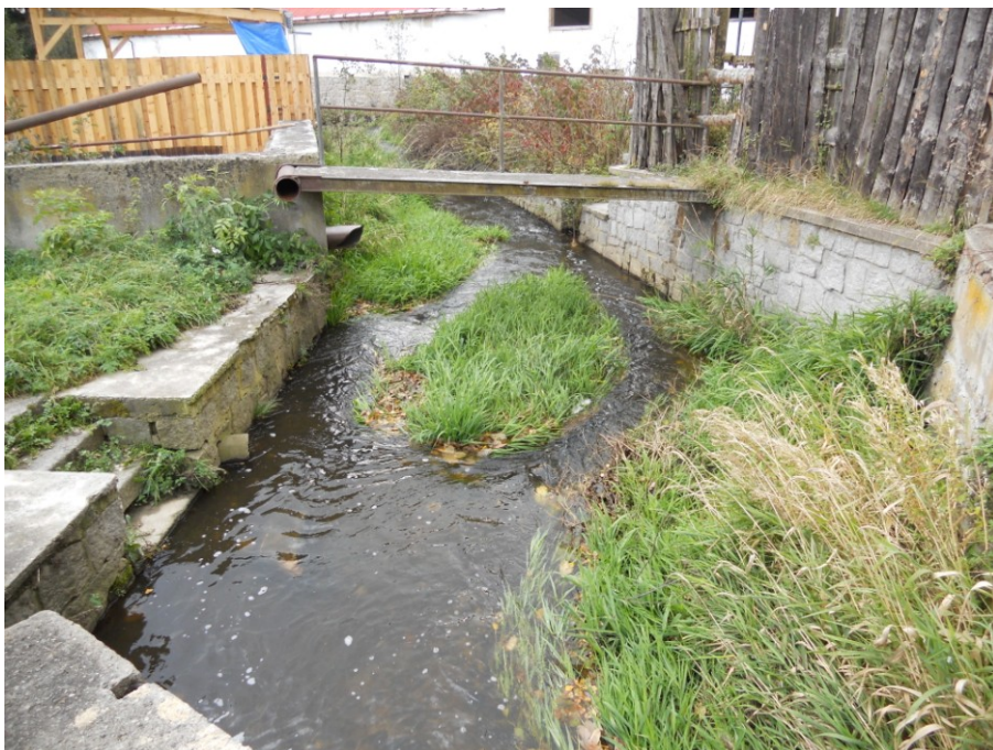
Obr. 21 Betonem opevněné koryto se zaneseným a zarůstajícím dnem
