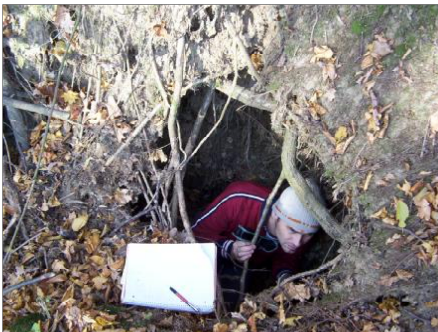
Foto 14: Porušený strop sufozní dutiny 5b (foto: M. Hořáková, 29. 10. 05)
