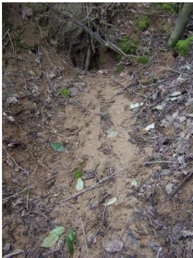
Foto 7: Vyústění sufozní dutiny na lokalitě 1, jev Ib (foto: M. Hořáková, 19. 2. 07)
