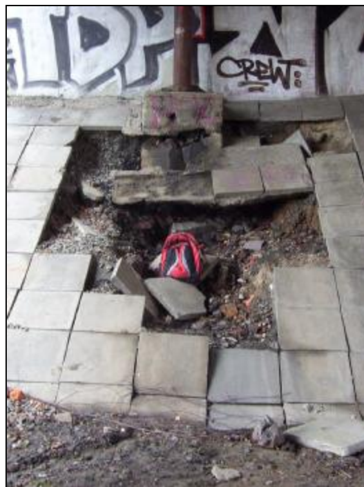
Foto 6: Antropogenní sufoze v Olomouci pod mostem na ulici Brněnská (foto: M. Hořáková. 2006)
