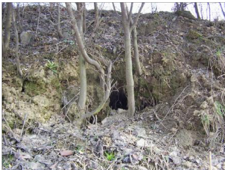
Foto 4: Vyústění sufovní dutiny Ig směrem k silnici (foto: M. Hořáková, 8. 4. 06)
