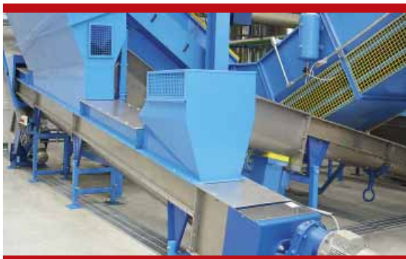
Raccolta scarti centralizzata Centralized waste collection
