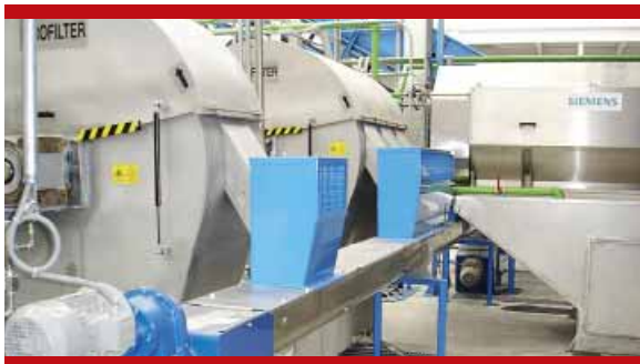
Filtrazione meccanica Mechanical filtration
