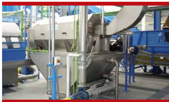
Filtrazione acqua Water filtration
