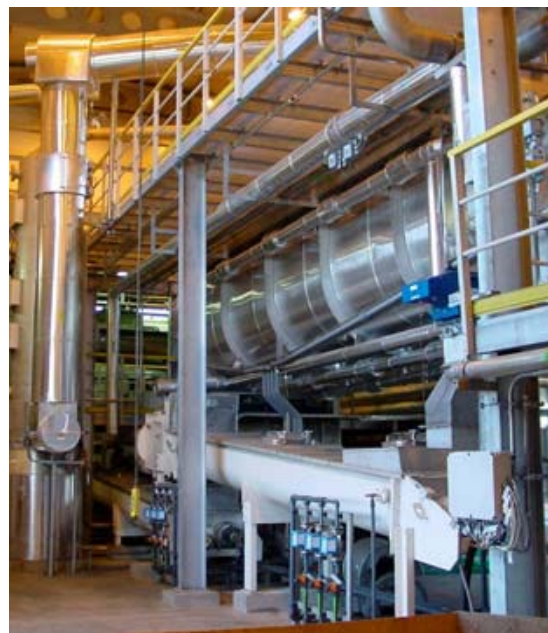
Sušení kalu ČOV Brno - Modřice
