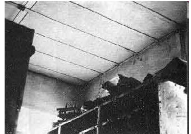
Strop místnosti, kde pracoval Yusia a Bullen; Stěny byly znečistěny výkaly netopýrů.
