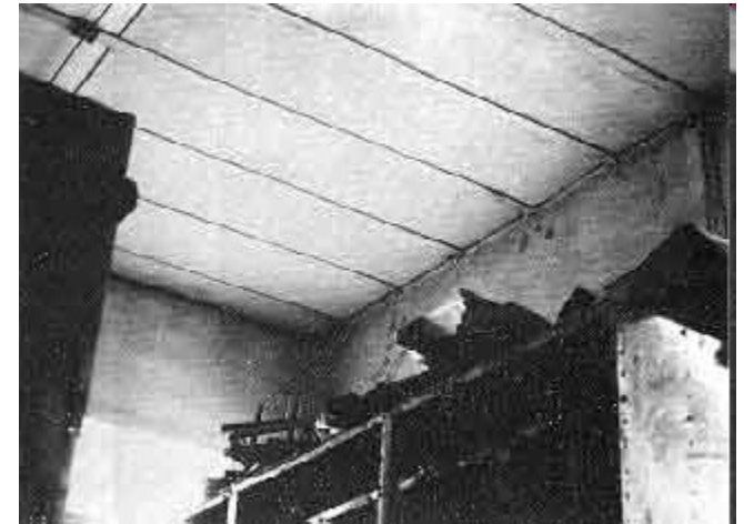
Strop místnosti, kde pracoval Yusia a Bullen; Stěny byly znečištěny výkaly netopýřů.
