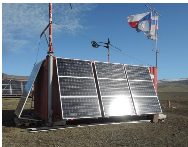
Obr. 1 Jeden z kontejnerů s instalovaným fotovoltaickým systémem.
