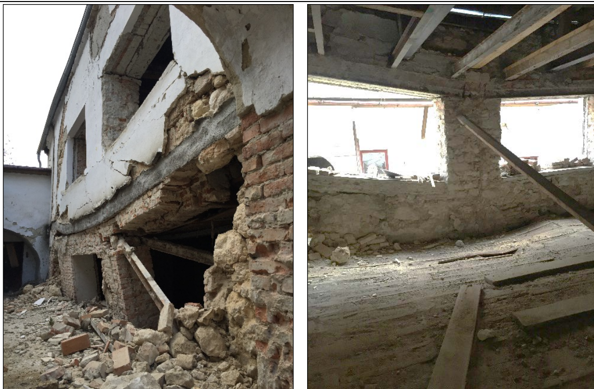
Obr. 5 – Nový železobetonový věnec. Obr. 6 – Vyboulení meziokenního pilíře.
