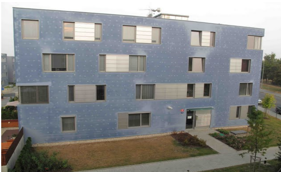
Obr. 1 – Na fasádě jsou patrné kotvy a skladba desek KZS Fig. 1 – There are visible anchors and ETICS insulating boards on the facade
