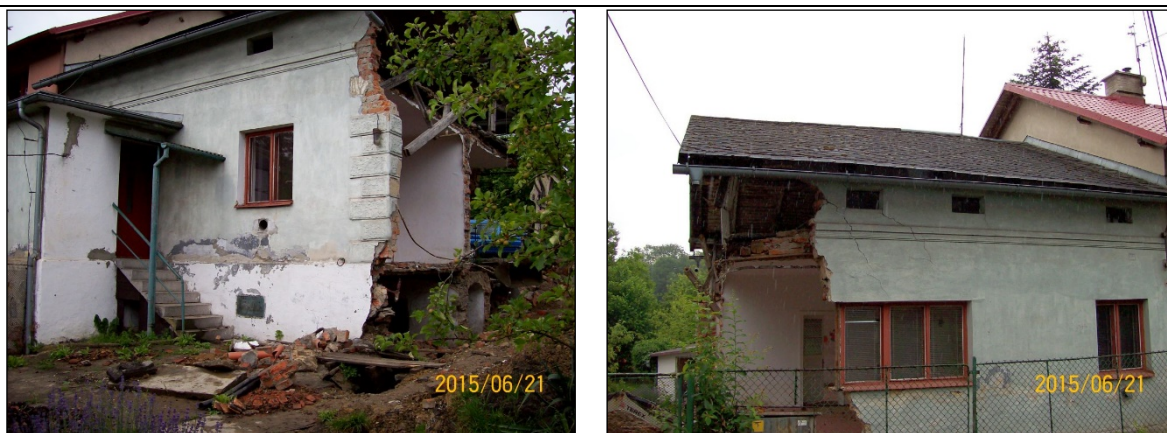
Obr. 1 – Havarovaná část štítové stěny ze dvora. Obr. 2 – Havarovaná část štítové stěny z ulice.
