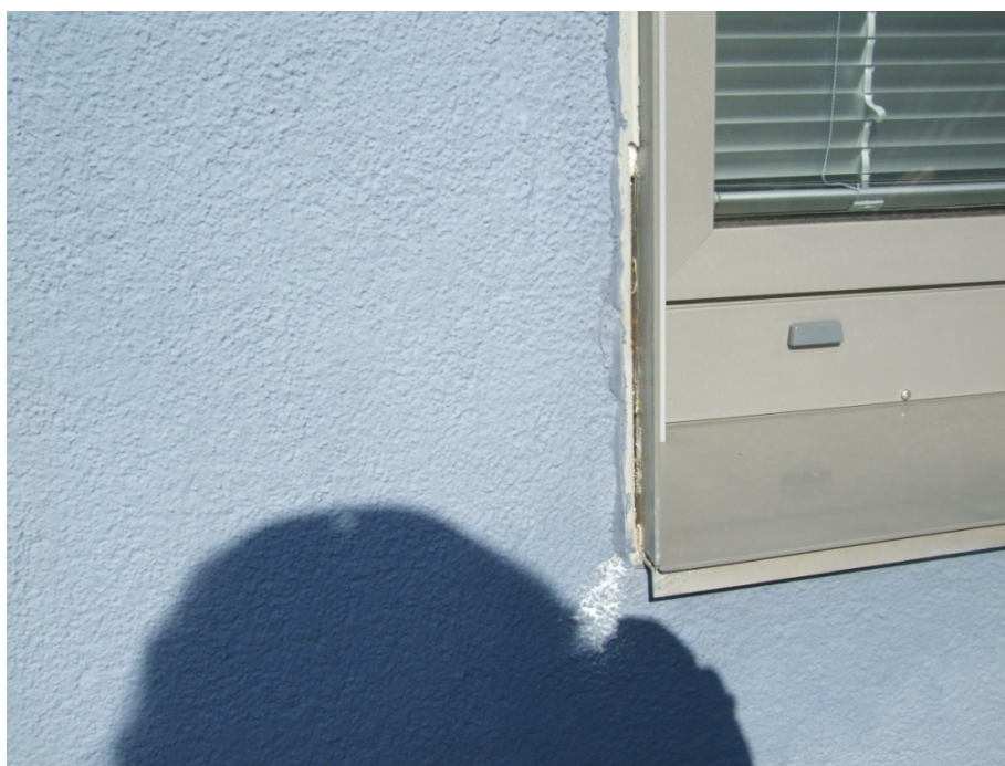
Obr. 2 – Netěsné napojení KZS a detailů parapetu a ostění Fig. 2 – Non-leak-tight connection of ETICS and window jambs details
