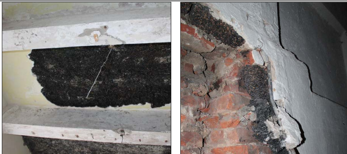
Obr. 3 – Obložení stropní desky korkolitem. Obr. 4 – Zjištěný obklad stěn korkolitem.
