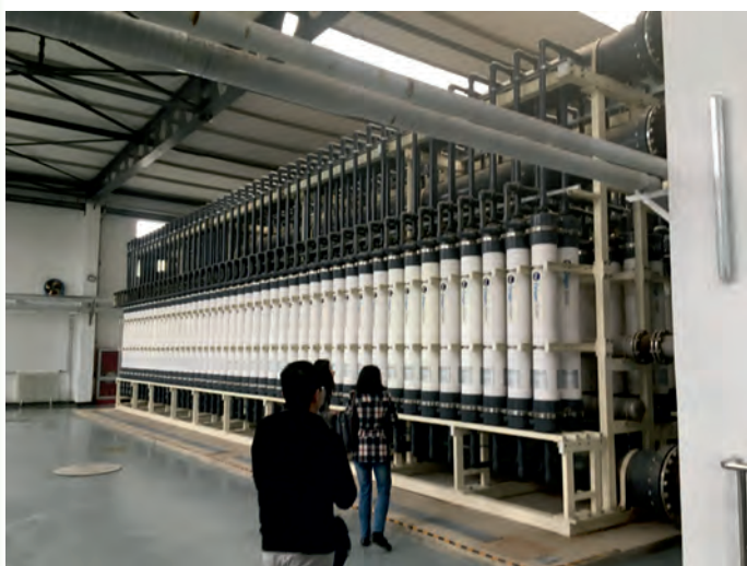
ČOV Peking Xiaohongmen – membránová filtrace odtoku pro recyklaci vyčištěné odpadní vody
