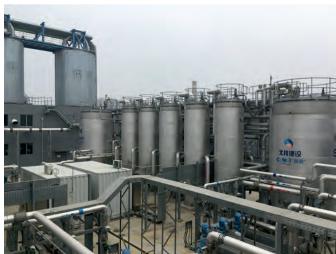
ČOV Peking Xiaohongmen – termická hydrolýza kalů
