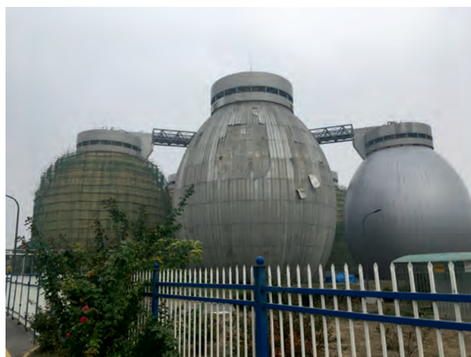
ČOV Peking Xiaohongmen – anaerobní stabilizace kalů
