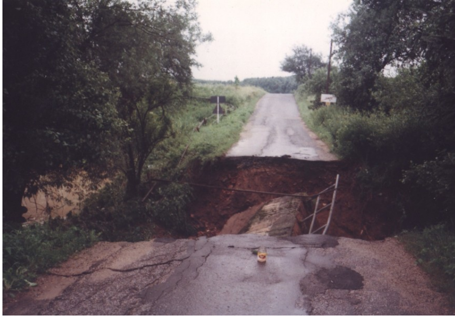
Obr.3 - Škody po extrémních srážkách - most přes místní potok v Janově
