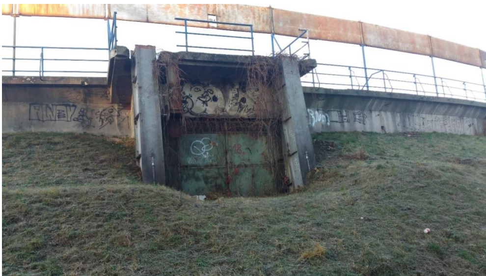
Obr. č. 9: Stav tribun fotbalového stadionu Za Lužánkami (zdroj: studentské foto)
