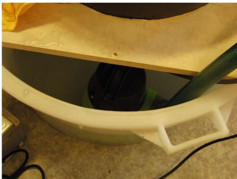
Obrázek 3.7: Čerpadlo v zásobníku vody
