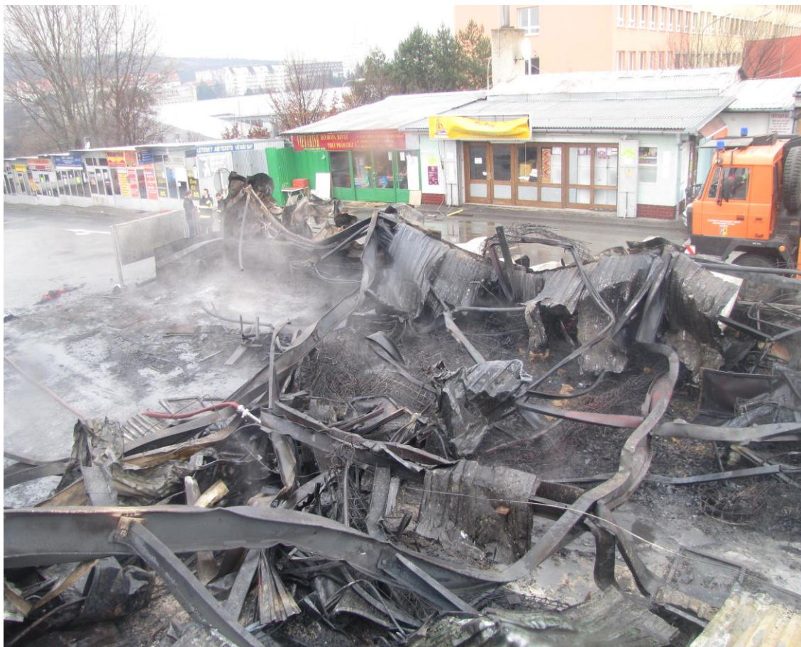
Zřícené ocelové konstrukce – Tržnice Olomoucká, Brno 2011.
