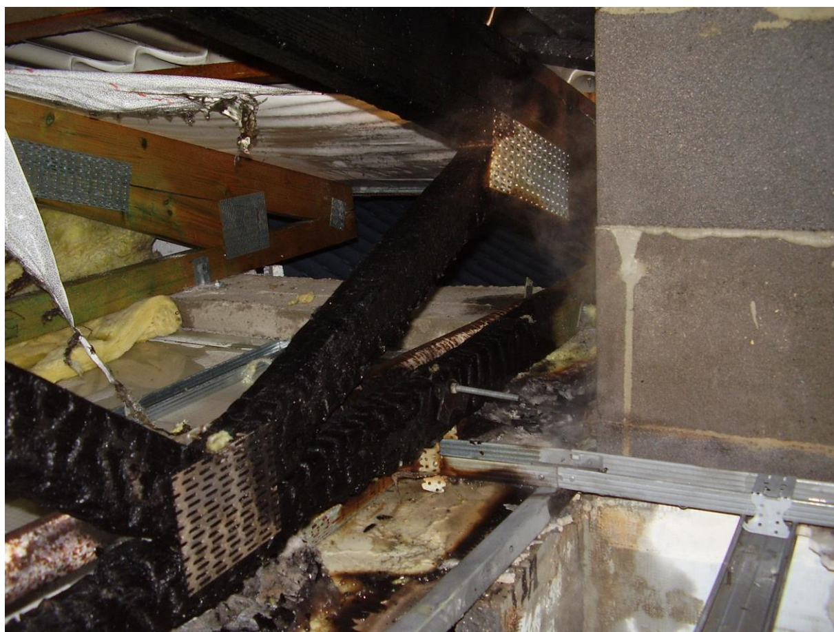
Krov rodinného domu po požáru
