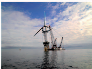
Obrázok 10.8 Stavba Beatrice, ukážka veternej turbíny v hlbokých moriach. Fotografie poskytla Talisman Energy (UK) Limited.
