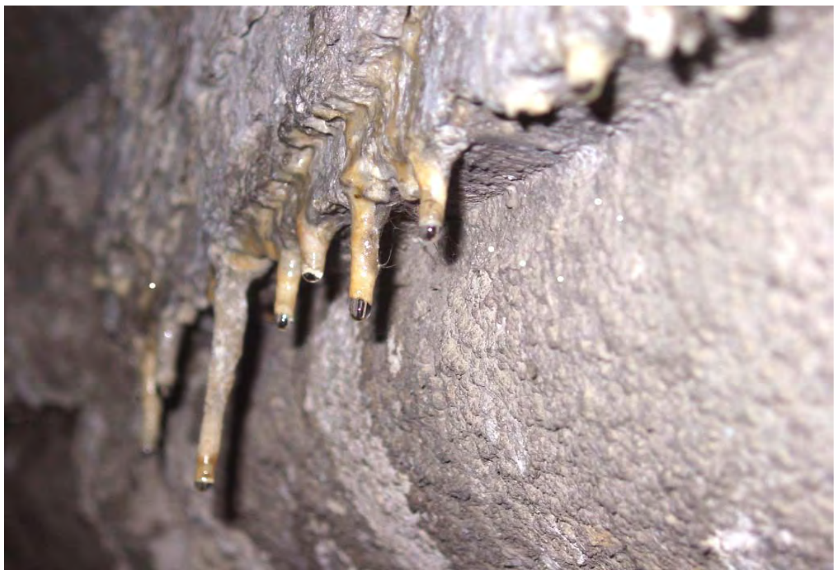
Foto č. 2. Krápníková výzdoba konstrukce pilíře želez/ničního mostu v Brně (foto J. Nezvalová, 2002)
